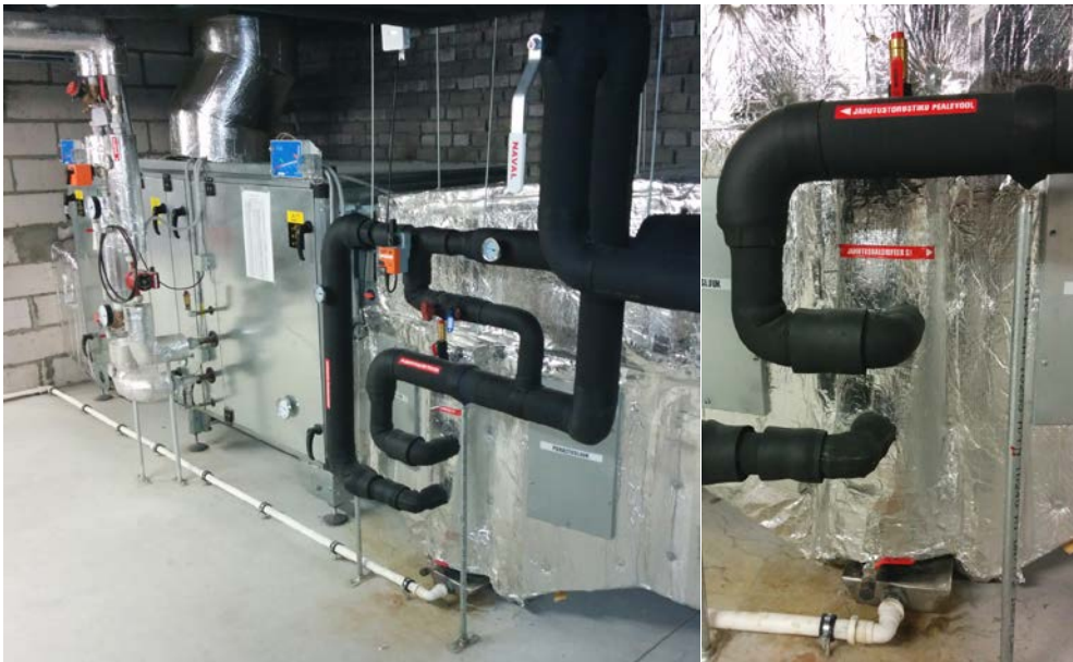
Joonis A.3. Sissepuhke-väljatõmbe ventilatsiooniseade ja sellele hiljem paigaldatud jahutuskalorifeer
