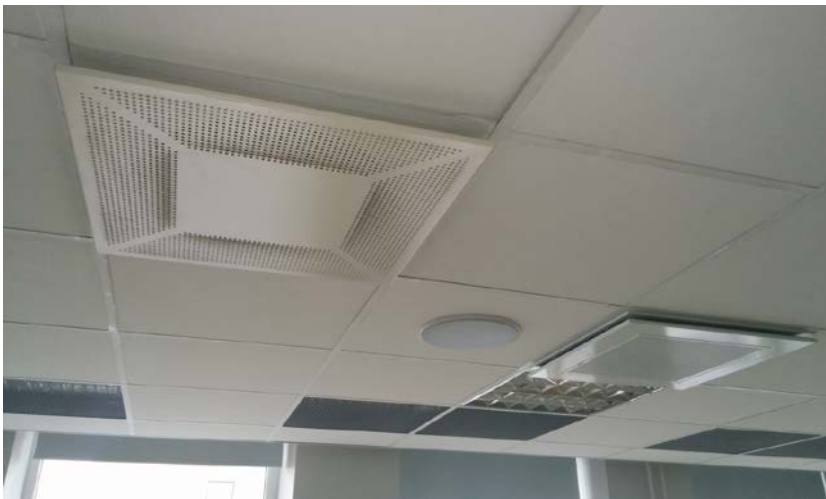
Joonis A.4. Auditooriumi ripplaes paiknev sissepuhke õhujagaja ja (vasakul), ventilaatorkonvektor (paremal). Nende vahel asub kõlar.
