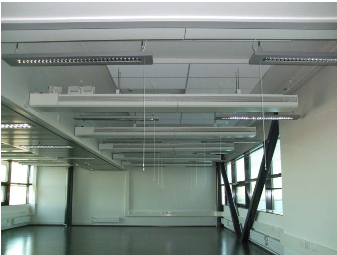
Joonis 6.10. Kontoriruumi lakke on paigaldatud aktiivsed jahutustalad, mille kaudu toimub ka mehaaniline sissepuhe. Eeldused II sisekliimaklassi tagamiseks, kuid projekteerimine nõuab õhukiiruste analüüsi.
