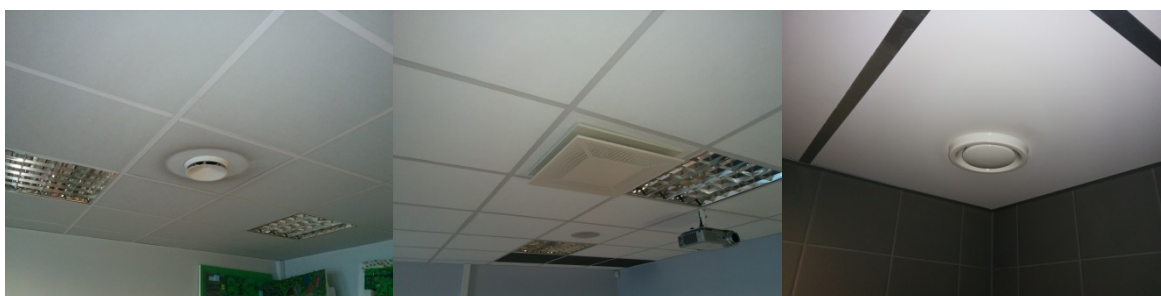
Joonis A.2. Mehaanilise ventilatsiooni lõppelemendid, kaks vasakpoolset on sissepuhkeks ja parempoolne väljatõmbeks.
