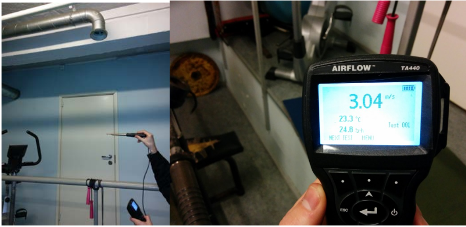
Joonis 6.4. Mehaanilise ventilatsiooni korral, mille lõppelemente on omavoliliselt reguleeritud või kahjustatud, ei ole õhuvooluhulgad ja müratasemed tõendatud. Pildil kujutatud juhul ületab õhu liikumiskiirus ruumis rohkem kui 10-kordselt tavapäraseid piirväärtusi. Tagatakse sisekliimaklass IV.
