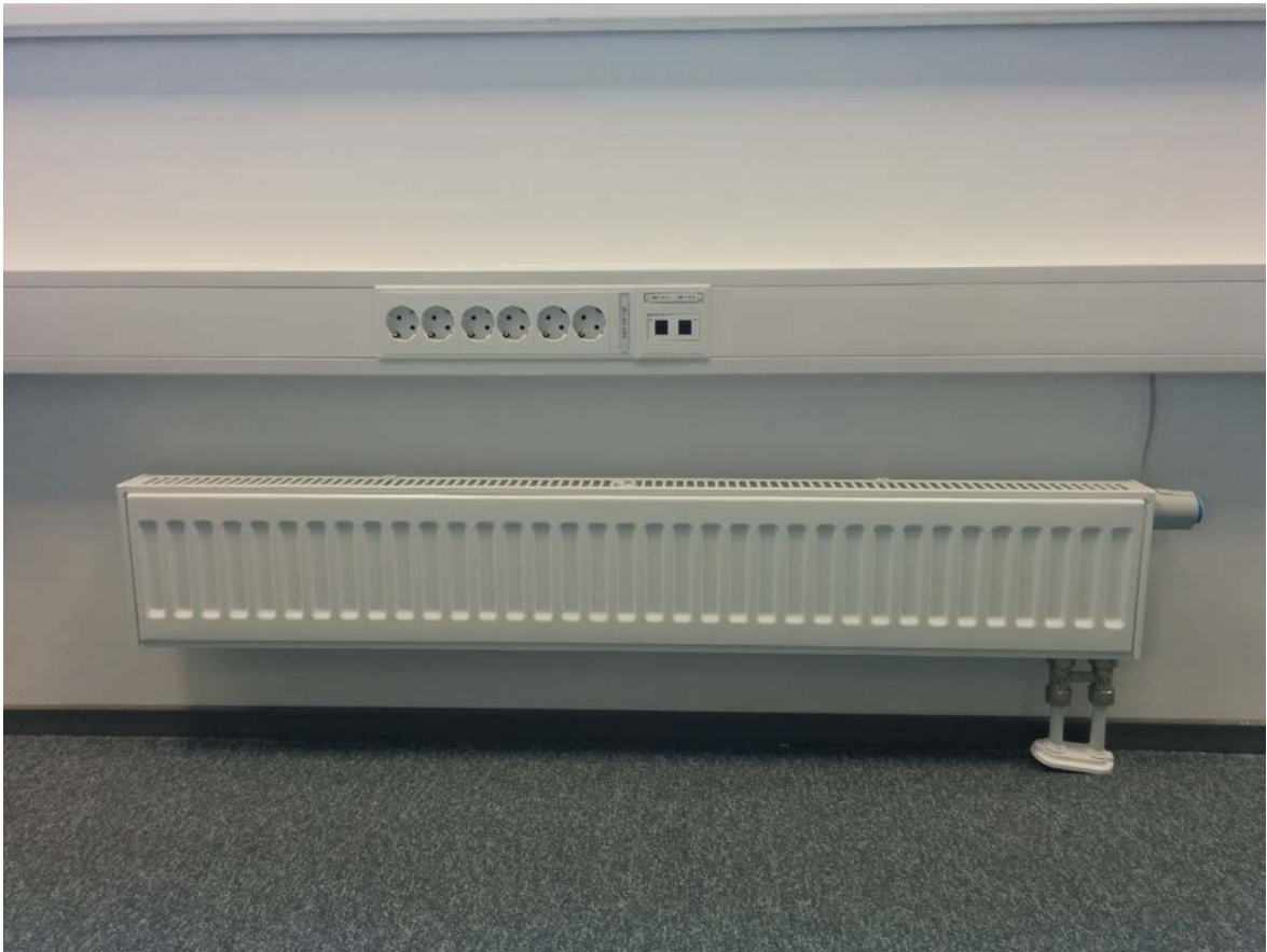
Joonis B.1. Ruumide kütmiseks kasutatakse teraspaneelradiaatoreid, mis on varustatud termoajamiga reguleerventiilidega.
