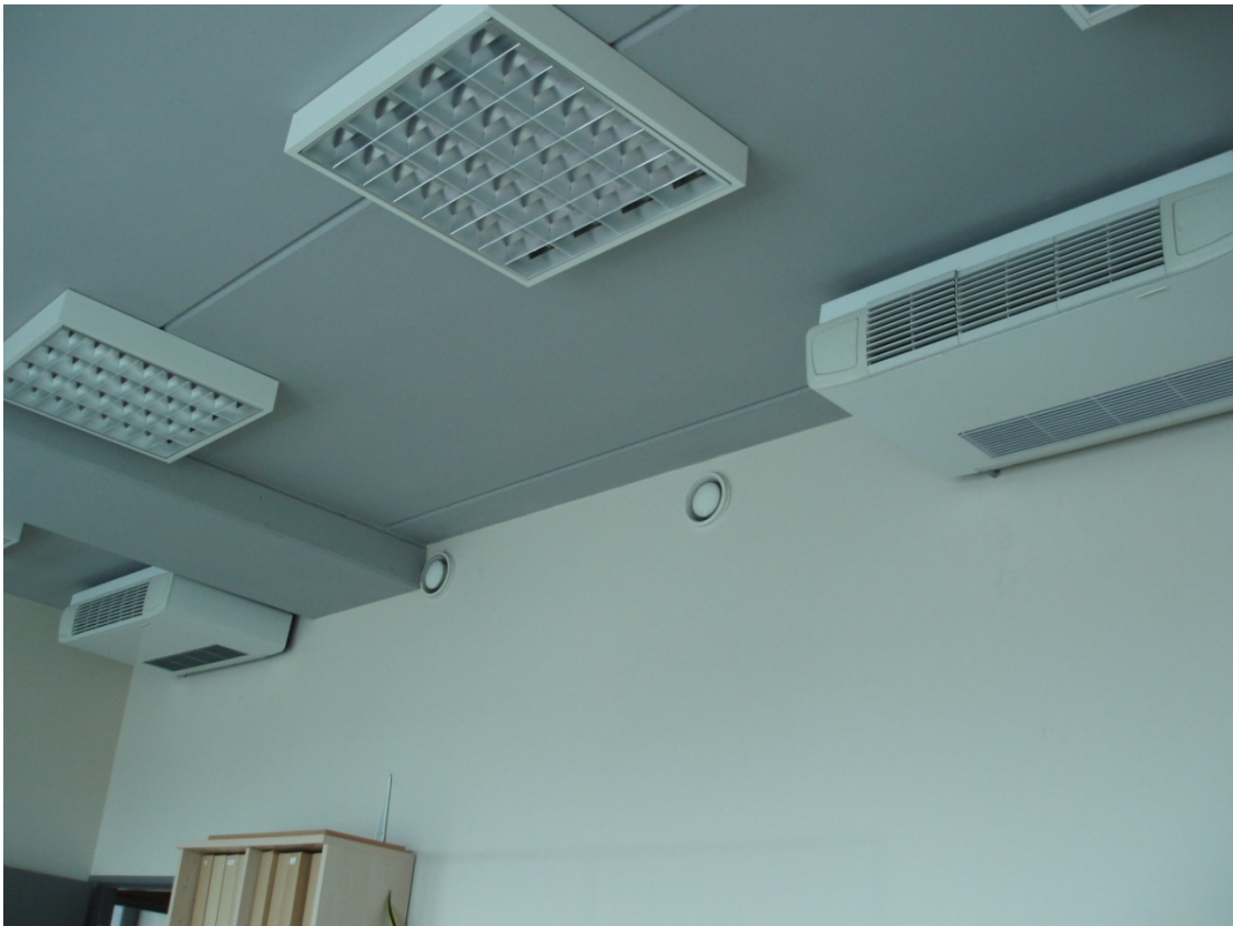
Joonis 6.9. Kontoriruumi lakke on paigaldatud ventilaatorkonvektorid, mis puhuvad madala temperatuuri ja suure õhuvooluhulgaga joa piki lage välisseina suunas. Ruumis on olemas töökorras jahutussüsteem, kuid suure tõenäosusega on välisseina ääres asuvatel töökohtadel õhu liikumise kiirus liiga suur ja tagatakse eeldatavasti III sisekliimaklass.
