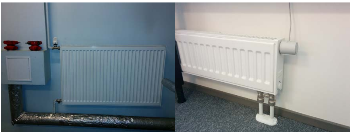
Joonis 6.2. Radiaatorid, millel on olemas ruumipõhise temperatuuri reguleerimise võimalus. Vasakpoolsel pildil on omajõuline termostaatventiil, parempoolsel elektrilise ajamiga reguleeriventiil. Puuduvad takistused I või II sisekliimaklassi saavutamiseks.
