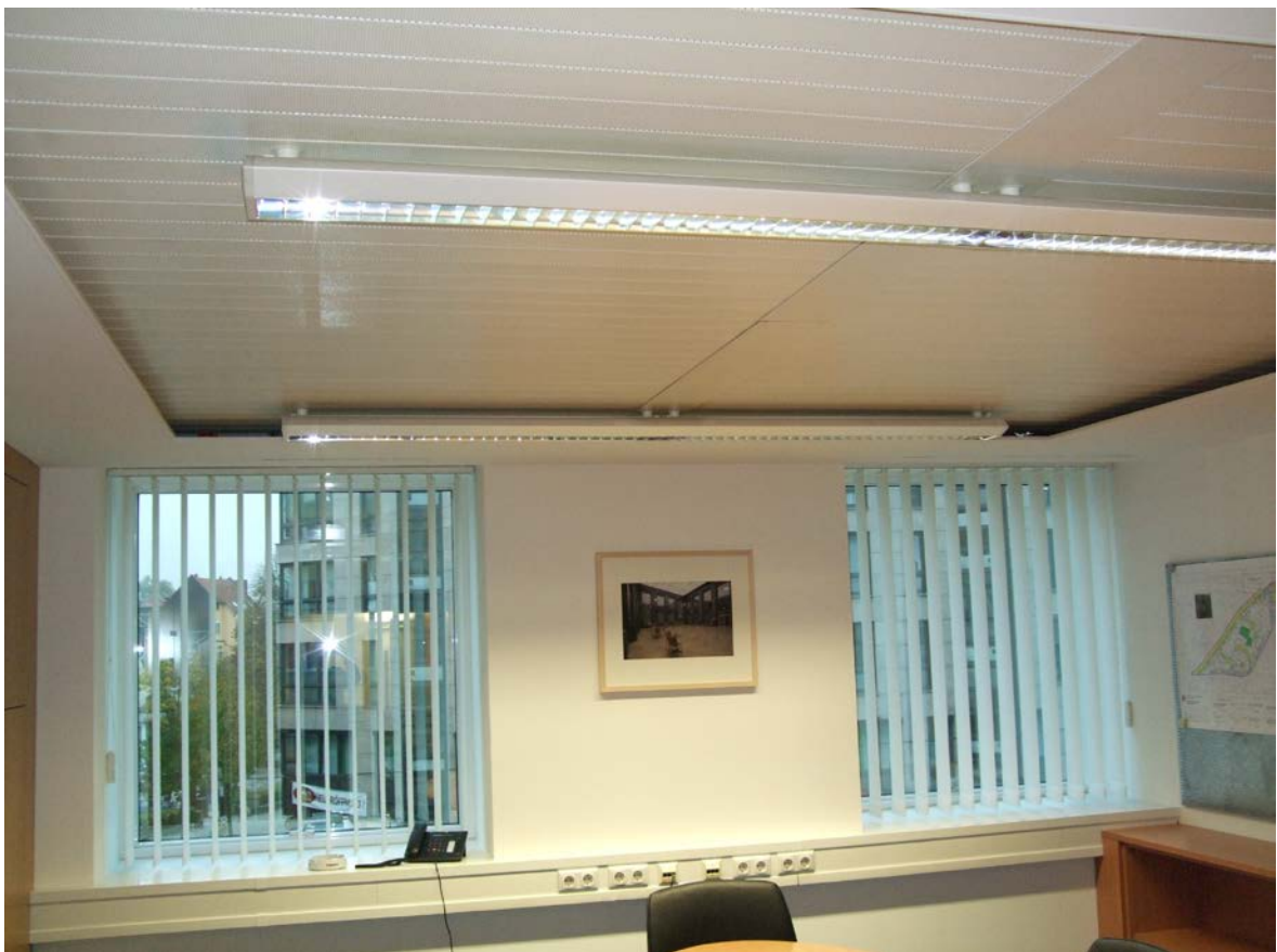
Joonis 6.12. Kontoriruumi lakke on paigaldatud kiirgurid nii kütmiseks kui ka jahutamiseks. Nii kütmine kui ka jahutamine toimub kiirguslikul teel suuri õhukiirusi põhjustamata ja on loodud eeldused I sisekliimaklassi saavutamiseks.
